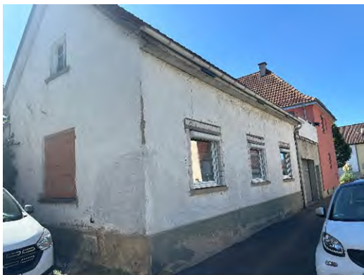
Abbildung 29: Bausubstanz mit schwerwiegenden Mängeln in der Friedrich-Ebert-Straße (Quelle: WHS, 2025)
