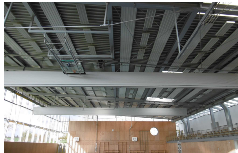
Deckenansicht der dreigeteilten Eberwinhalle mit der alten Beleuchtung
