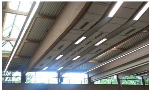
Abgehängte T8 Rasterleuchten zwischen Lüftungskanäle und Leimbinder
